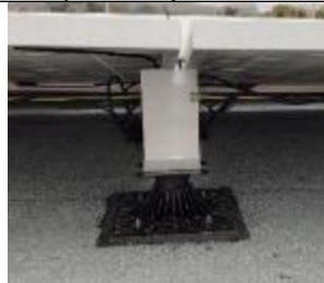
Mise à la terre réhausse 200 & 210 aluminium sur système Soprasolar Fix Evo TILT par clip Rayvolt®
